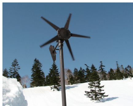
富士見小屋の風力発電装置
